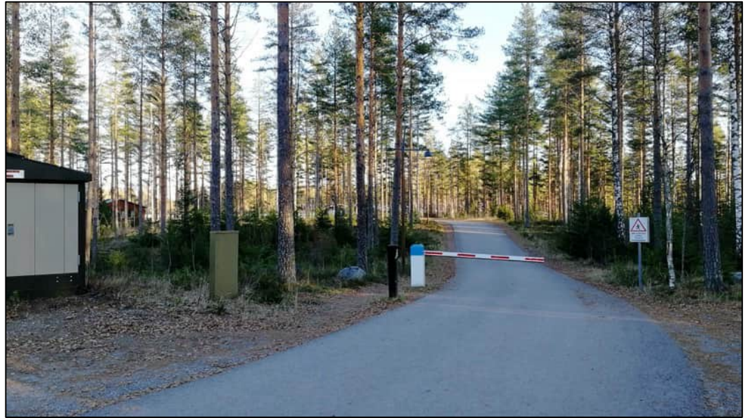
Kuva 2. Rampsintien alkupään puistomuuntamo ja puomi.
